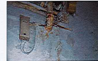
Réseaux intérieurs défectueux
