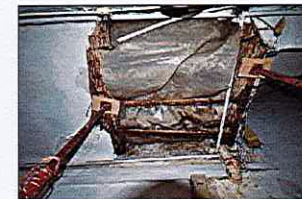
Partie de plancher manquante à la suite probable de fuites
