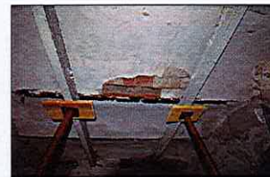
Fléchissement des poutres des voutains
