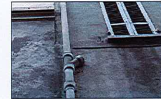
Réseaux extérieurs défectueux
