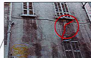
Fissures et ruptures dues à des tassements différentiel
