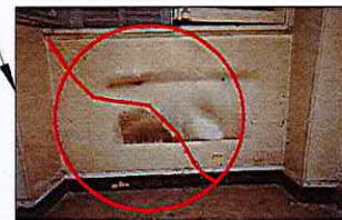
Fissures en allège, correspondance intérieure
